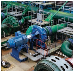
Насосная станция РНС-2 «Мотовилиха» г.Пермь
